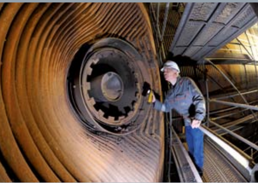
Blick in den Brenner eines Kessels (Foto: Andreas Seidel, Chemnitz)
