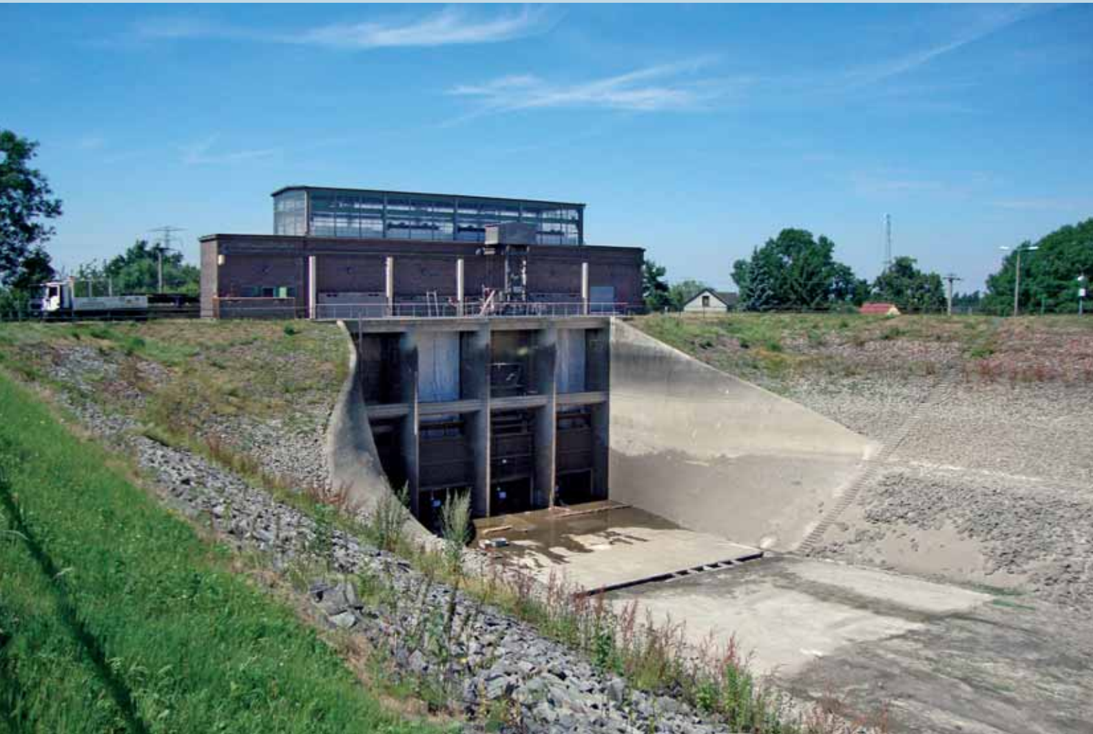
Einlaufschütz am Oberbecken
