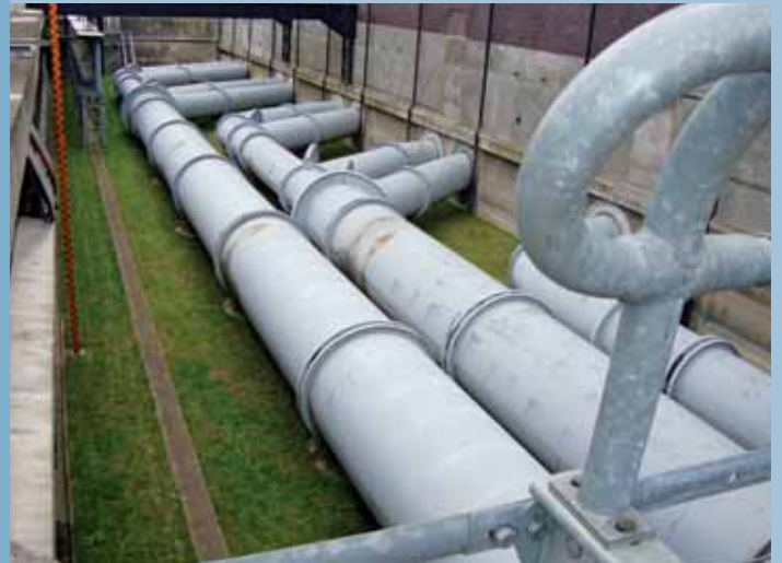
Leitungszuführungen zum Turbinenhaus
