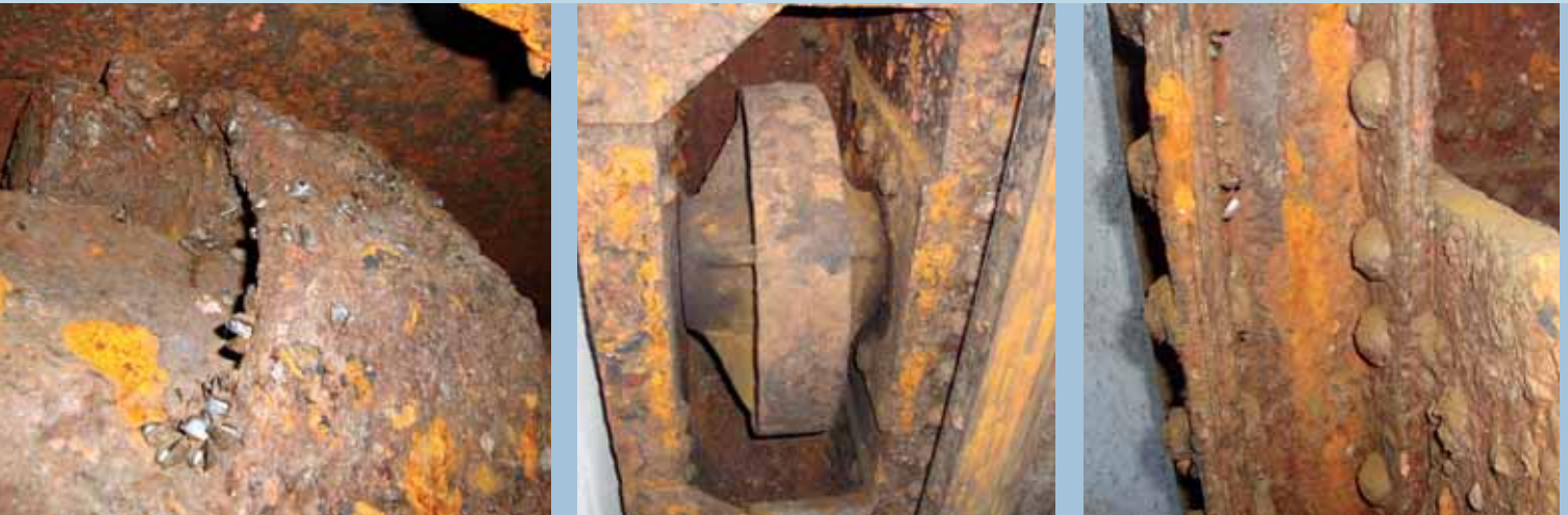
Starker Plattenrost und Muschelablagerungen an PSW-Bauteilen: Befestigungselement, Führungsrolle und Nietverbindung von Profil und Blech
