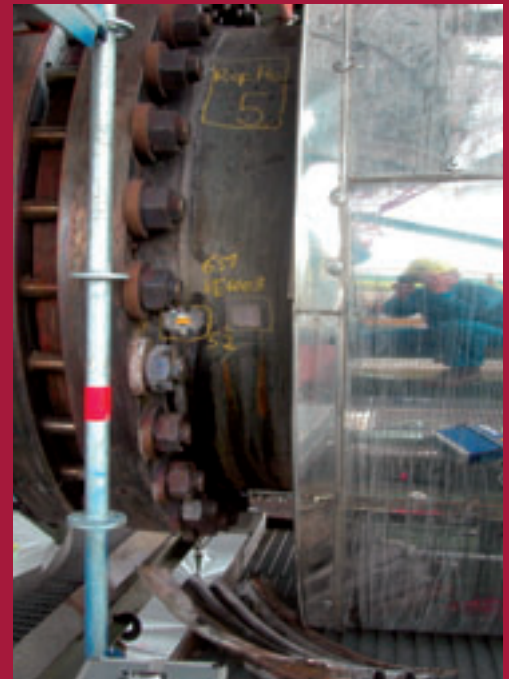
Replica-Untersuchung an einer Flansch-Schweißnaht
